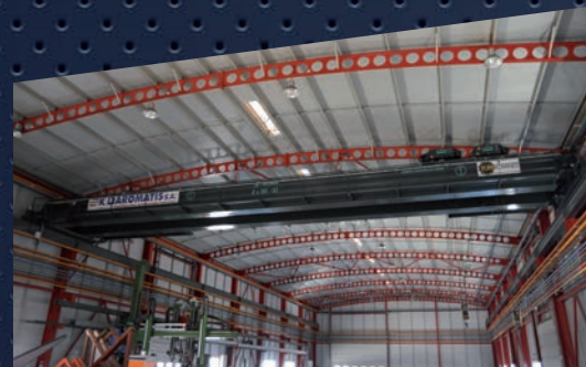
Επικαθήμενες Γερανογέφυρες 2 τμχ Διπλού Φορέα 20tn x 26m με ανυψωτικό εξοπλισμό Verlinde. Εγκαταστάσεις Κ. Λιαρομάτης 2007, ΒΙ.ΠΕ. Πατρών
