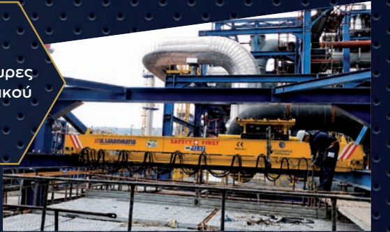
Επικαθήμενη Γερανογέφυρα Διπλού Φορέα 5tn x 12m με ανυψωτικό εξοπλισμό Verlinde. Πελάτης: Ελληνικά Πετρέλαια 2015, Ασπρόπυργος, Δυτική Αττική
