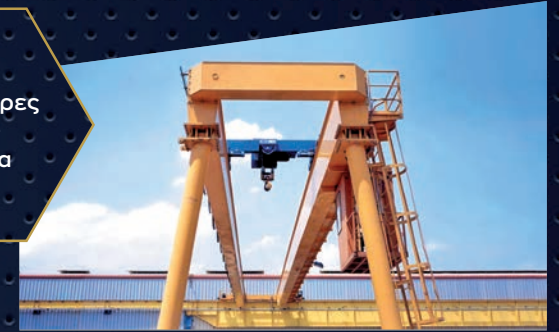
ΗμιΠυλώνες 2 τμχ 10tn x 30m με ανυψωτικό εξοπλισμό Demag. Πελάτης: Σωληνουργεία Κορίνθου 2000, ΒΙ.ΠΕ Θέσβη Βοιωτίας
