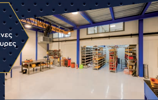
Αναρτώμενη Γερανογέφυρα Μονού Φορέα 5 tn x 15m με ανυψωτικό εξοπλισμό Verlinde. Πελάτης: Kotronis Packaging 2016, Ευπάλιο Φωκίδας
