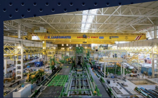
Επικαθήμενη Γερανογέφυρα Διπλού Φορέα 32/5tn x 41.4m με ανυψωτικό εξοπλισμό Demag. Πελάτης: Teka Systems 2021, Οινόφυτα Βοιωτίας
