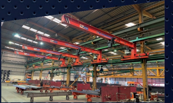
Επιτοίχιοι Γερανοί 16 τμχ - 1,6tn x 8m με ανυψωτικό εξοπλισμό Verlinde. Εγκαταστάσεις Κ. Λιαρομάτης 2023, ΒΙ.ΠΕ. Πατρών
