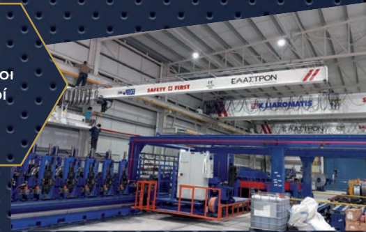
Επιτοίχιος Γερανός 1,6tn με ανυψωτικό εξοπλισμό Verlinde. Πελάτης: Elastron 2023, Ασπρόπυργος, Δυτική Αττική
