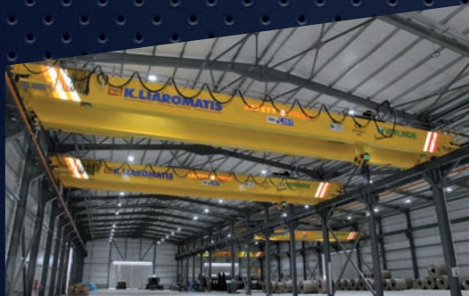
Επικαθήμενες Γερανογέφυρες 4τμχ Διπλού Φορέα 25tn x 20.62m με ανυψωτικό εξοπλισμό Verlinde. Πελάτης: Vriko 2022, Ασπρόπυργος, Δυτική Αττική
