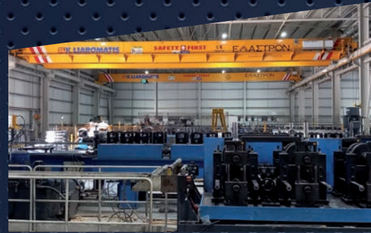
Επικαθήμενη Γερανογέφυρα Διπλού Φορέα 20tn x 24.35m με ανυψωτικό εξοπλισμό Verlinde. Πελάτης: Elastron 2022, Ασπρόπυργος, Δυτική Αττική
